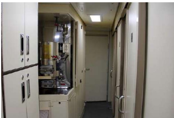
Рисунок 2.9 – Внешний вид котельного отделения специального вагона
